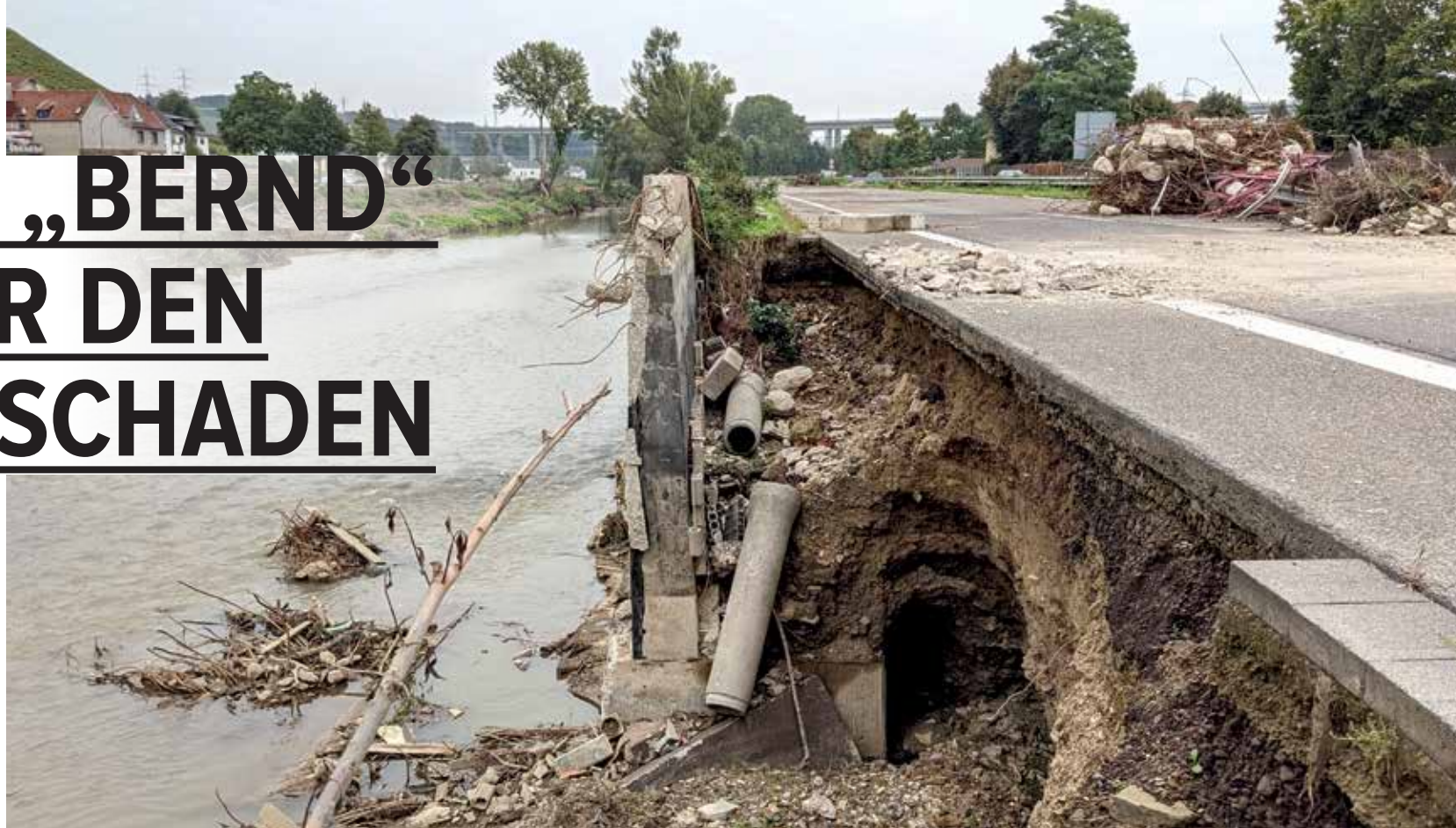
Überflutete Straßen, eingestürzte Häuser und abgeschnittene Städte: Tief „Bernd“ hinterließ in Teilen Deutschlands eine Spur der Verwüstung.
